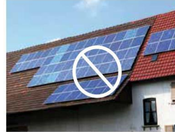
Les panneaux solaires sont souvent mal intégrés sur la toiture
