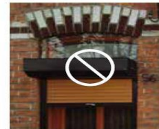
À éviter : un caisson sous un linteau courbé en saillie par rapport au nu du mur
